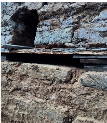
Figura 10. Viga de arrastre con daños por humedad y xilófagos.
