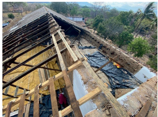
Figura 11. Sustitución de caballete y estructura de madera dañada por humedad y xilófagos.
