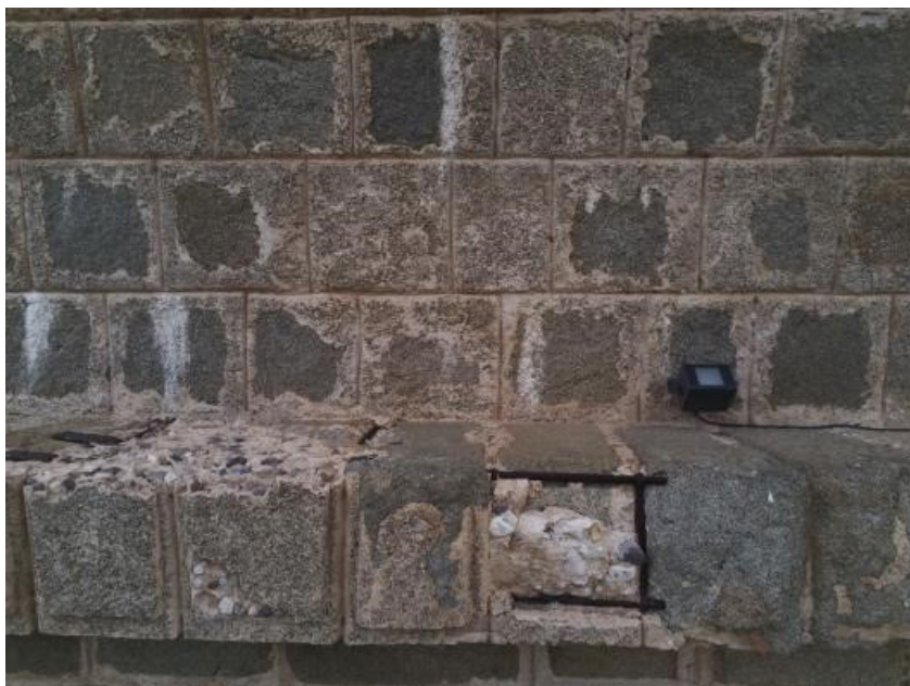
Figura 24: Detalle de la cornisa reconstruida con hormigón armado en la primera pila, en imagen tomada con el drone cuadricóptero, donde se pueden observar desconchones y armadura de acero al descubierto (fotografía del autor).
