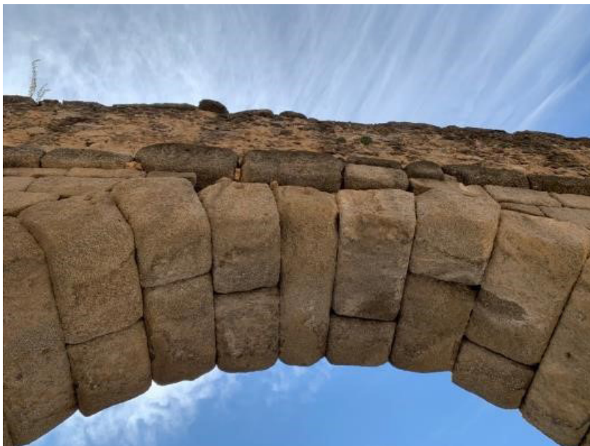
Figura 29: Imagen tomada con el dron cuadricóptero donde se aprecian pequeñas eflorescencias detectadas en las dovelas del arco número 55 (contando desde la Casa de Aguas), ubicado frente al número 10 de la Calle Almira (fotografía del autor).
