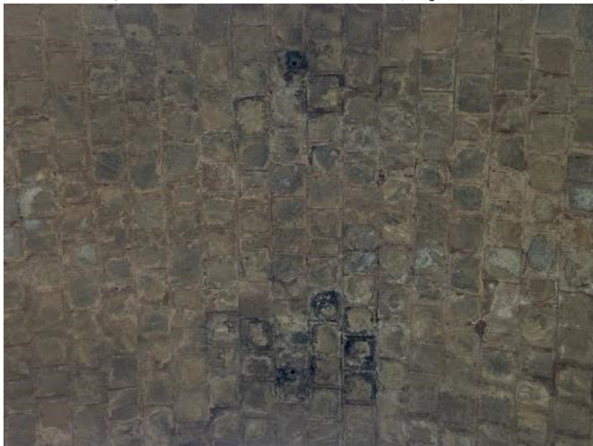
Figura 19: Imagen captada con el dron cuadricóptero en el interior de la segunda bóveda, donde se pueden observar lesiones diversas, tales como eflorescencias o costras oscuras (fotografía del autor).
