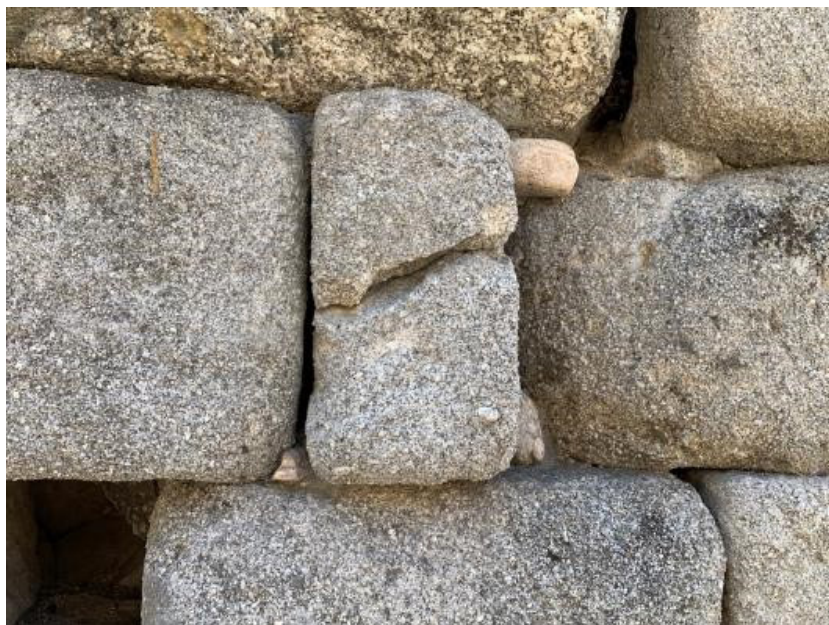
Figura 35: Sillar fracturado, detectado durante la inspección, en imagen tomada con el dron cuadricóptero (fotografía del autor).
