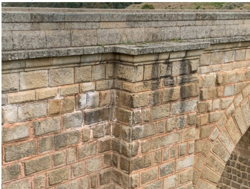
Figura 21: Detalle del estribo izquierdo (lado este, lado Alcántara), aguas arriba, en imagen captada con el dron cuadricóptero, donde se pueden observar restos de agua de escorrentía, presencia de vegetación y eflorescencias (fotografía del autor).
