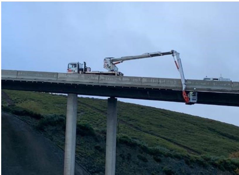
Figura 1: Inspección del tablero de un viaducto que salva la Autovía de las Rías Bajas (A – 52), a la altura del municipio de A Gudiña, en la provincia de Ourense, en España (fotografía del autor).
