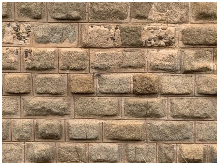
Figura 20: Imagen captada con el dron cuadricóptero observado en la Figura 16 y en la Figura 17, donde se puede apreciar un detalle del paramento de sillaría con las juntas rellenas de mortero, con ciertas fisuras sobre el mismo, además de sillares fracturados y otros sometidos a una reparación ya deteriorada (fotografía del autor).
