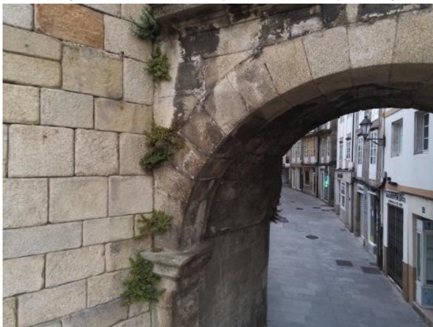
Figura 5: Imagen tomada por el drone durante la inspección de la Muralla de Lugo recogida en la Figura 3, que permitió observar la vegetación medrada sobre la fábrica y el deterioro del material pétreo (fotografía del autor).
