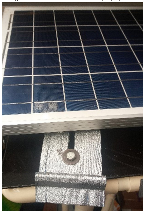
Figura 13. Panel solar. Elaboración propia, 2019.
