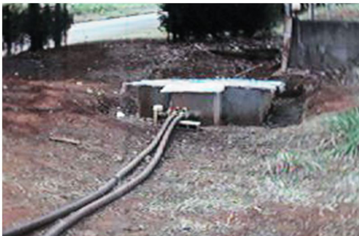
Figura 2 – Caixa de areia com as mangueiras coletoras.
