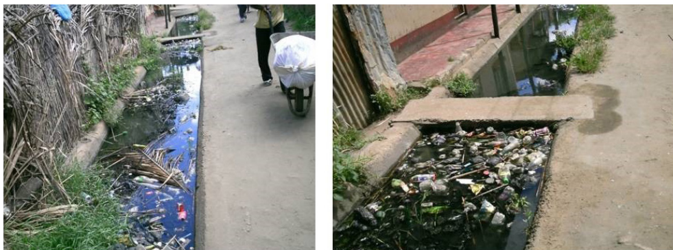
Figura 2. Canal de drenagem assoreado devido ao depósito de resíduos.
