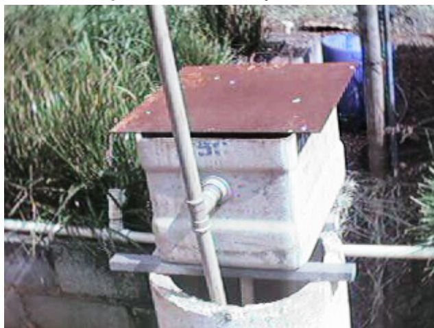
Figura 6 – Caixa de distribuição de vazão.
