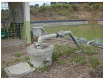
Foto1. Albarrada y sistema de bombeo
