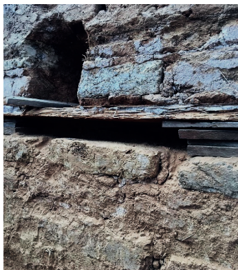
Figura 10. Viga de arrastre con daños por humedad y xilófagos.
