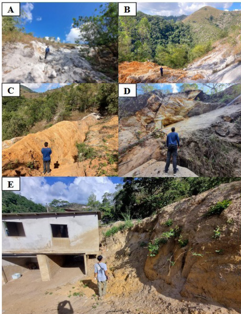
Figura 4 - Ponto 2 localizado na comunidade Morro do Sal: A e B) Visualização da corrida de detritos sobre o Quartzito; C) Cavas secas construídas a fim de conter os movimentos; D) Fraturas no Quartzito; E) Deslizamento planar invadindo casa dos moradores.
