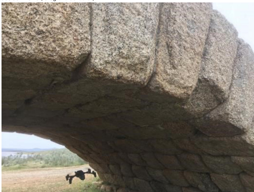
Figura 14: Drone cuadricóptero circulando por el interior del primer arco recogido en la Figura 13, para inspección del intradós del mismo (fotografía del autor).
