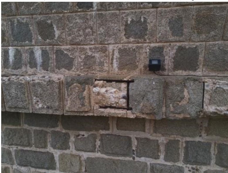
Figura 25: Detalle de la lesión recogida en la Figura 24, en imagen tomada con el drone cuadricóptero desde un ángulo ligeramente diferente, como confirmación de las observaciones realizadas (fotografía del autor).
