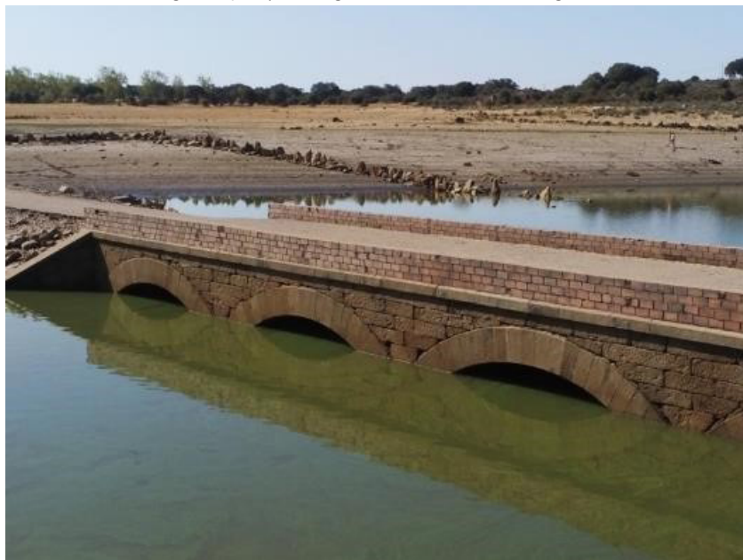
Figura 9: Imagen de un puente de fábrica anegado por las aguas del Embalse de Almendra, en el municipio de Monleras (Salamanca), tomada por un dron cuadricóptero. El dron pudo aproximarse al puente en un momento en el que el descenso de las aguas dejó el puente ligeramente descubierto (fotografía del autor).
