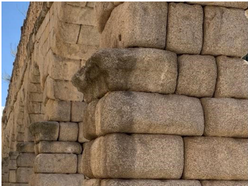
Figura 32: Marcas de agua de escorrentía sobre la cornisa de un pilar del Acueducto, en imagen tomada con el dron cuadricóptero, apreciándose, en segundo plano, vegetación enraizada en las juntas (fotografía del autor).
