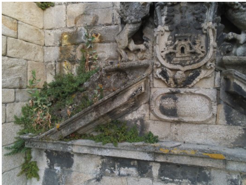
Figura 4: Imagen tomada por el drone durante la inspección de la Muralla de Lugo recogida en la Figura 3, que permitió observar la vegetación medrada sobre la fábrica y el deterioro del material pétreo a través de las costras de color negro y la eflorescencia observable en la parte superior izquierda (fotografía del autor).
