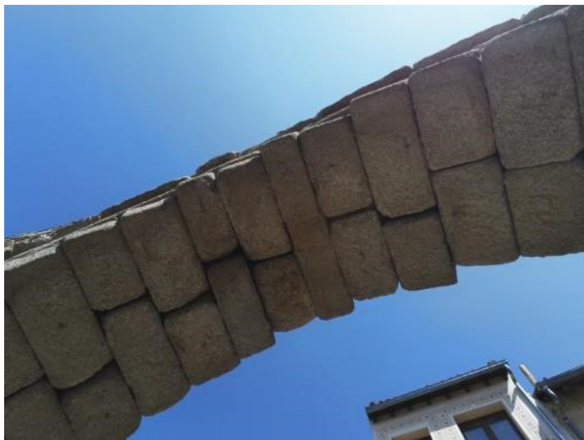
Figura 30: Imagen tomada con el dron cuadricóptero donde se aprecian ciertos desplazamientos de sillares en el arco número 23 (contando desde la Casa de Aguas), ubicado frente al número 28 de la Calle Almira (fotografía del autor).
