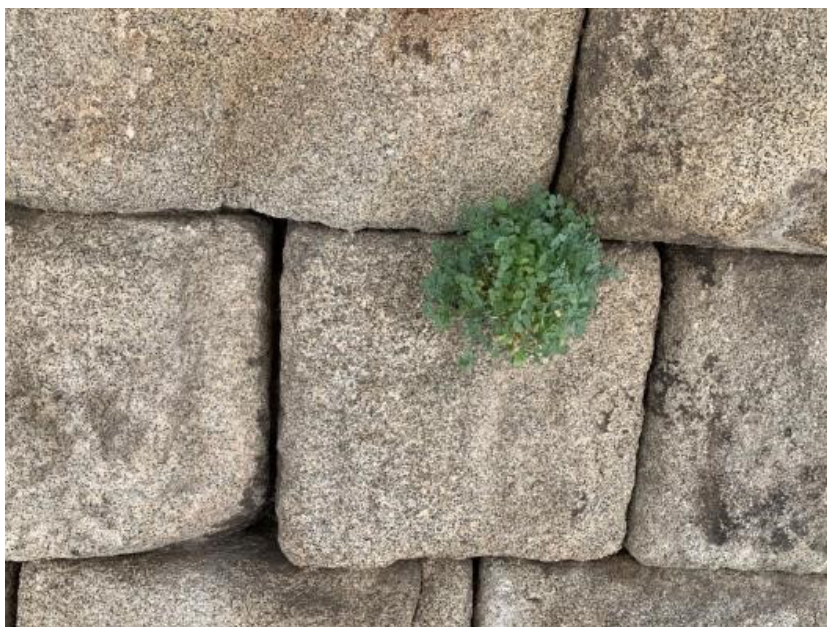
Figura 33: Imagen tomada con el dron cuadricóptero donde se observa una planta enraizada en una junta entre sillares y moteado de acción biológica sobre alguno de los sillares, fundamentalmente a la derecha (fotografía del autor).
