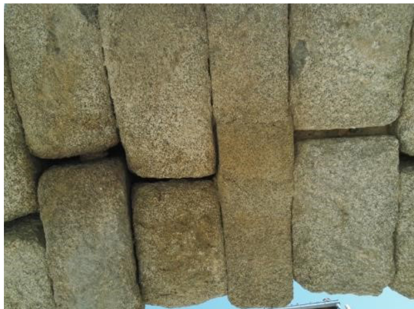
Figura 31: Imagen tomada con el dron cuadricóptero, que con mayor aproximación y detalle analiza el desplazamiento de sillares recogido en la Figura 30, donde se observa el rozamiento entre las dovelas (fotografía del autor).
