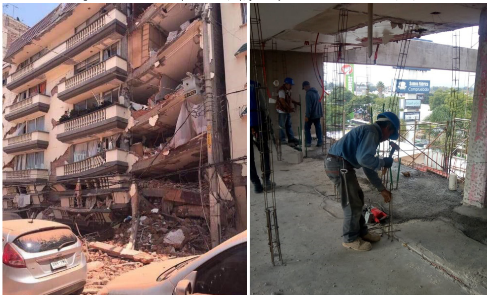
Fig. 3: Edificios dañados por sismo (izq.) y trabajos de refuerzo estructural (der.).
