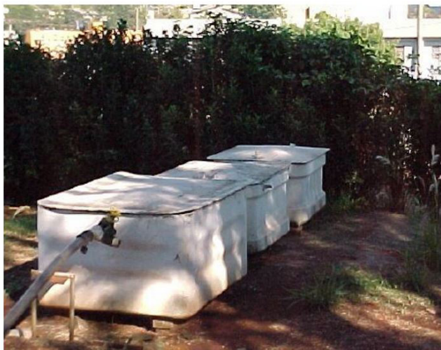
Figura 3 –Tanque séptico utilizado na distribuição da água residuária.
