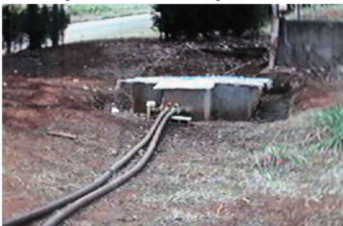
Figura 2 – Caixa de areia com as mangueiras coletoras.
