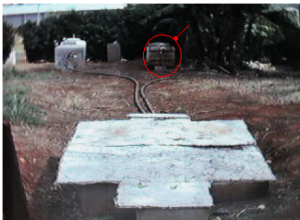
Figura 4 – Caixa de areia onde é captado o esgoto para tratamento. Ao fundo em destaque o tanque séptico modificado.
