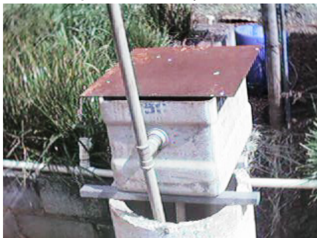
Figura 6 – Caixa de distribuição de vazão.
