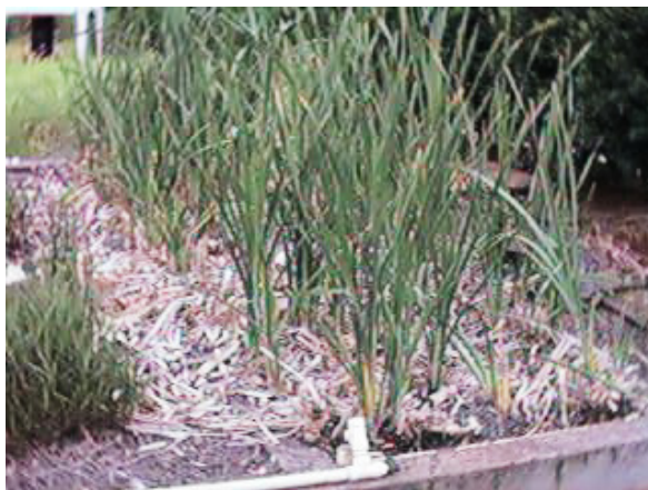
Figura 8 – Leito retangular (4x1m). Pode-se verificar a existência do material de suporte brita n.º 2 juntamente da linha em PVC de distribuição.
