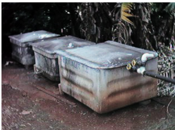
Figura 5 – Tanque séptico utilizado na distribuição da água residuária.
