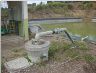
Foto1. Albarrada y sistema de bombeo
